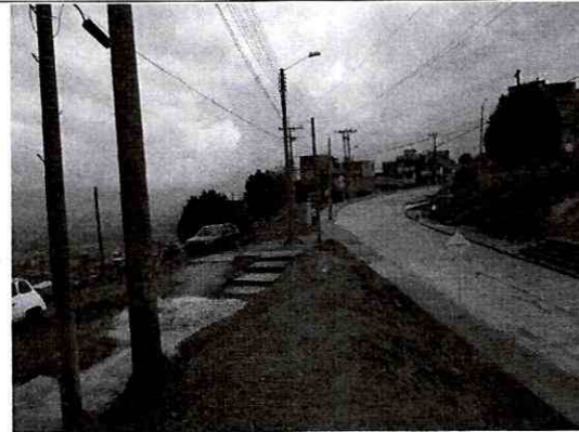
Fotografía No. 8. Vista de la Calle 75B Sur. Se observó algunos hundimientos en la vía.
