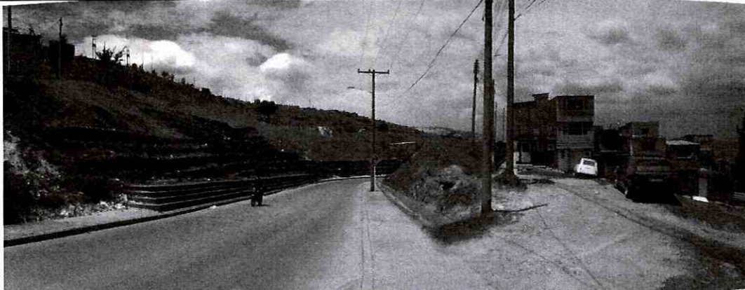
Fotografía No. 8. Vista de la Calle 75B Sur. Se observa hacia la zona sur-occidental la presencia de estructuras de contención y estabilización, y la deformación del muro en gaviones asociadas a inestabilidad geotécnica.
