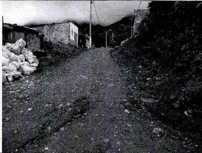
Fotografía No. 3. Vista del sector sobre la Calle 76 C Sur, se observa el estado de las vías sin pavimentar y la carencia de obras complementarias para el manejo de aguas de escorrentía.
