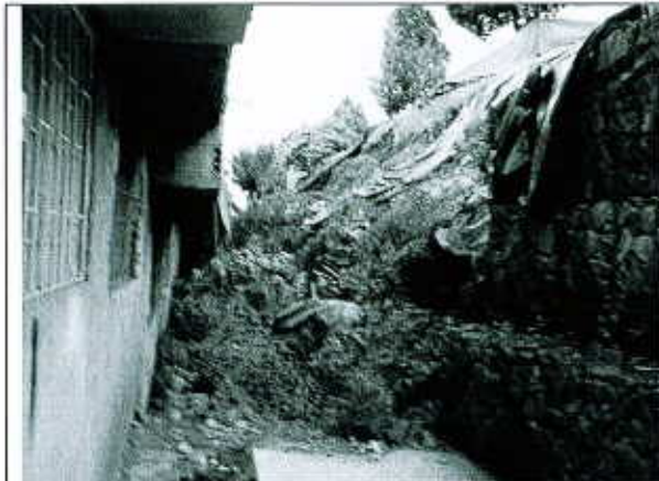
Fotografía No. 3. Afectación por proceso de remoción en masa en la parte posterior del predio del proyecto ubicado en la Calle 20 A Sur # 2 – 14, de la Localidad de San Cristóbal.
