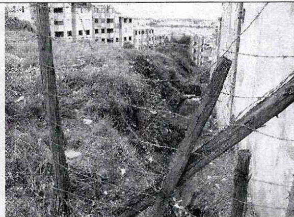
Fotografía No. 2. Rellenos antrópicos de considerable espesor al occidente de predio ubicado en la Carrera 87B No. 128C-58
