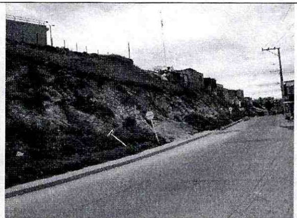
Fotografía No. 4. Escarpes, degradación y erosión de Arcillolitas a lo largo de la Diagonal 79 Sur (Costado sur del proyecto).
