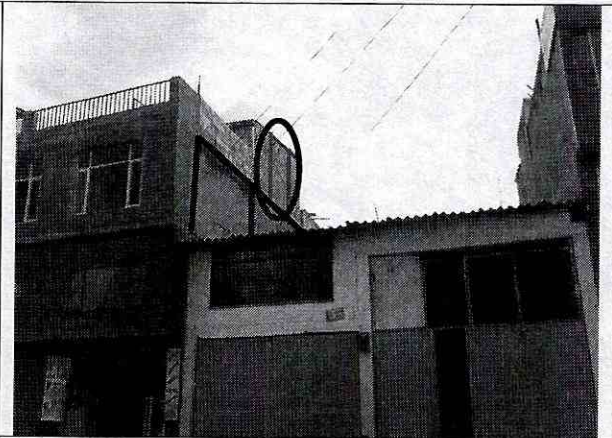
Fotografía No. 2. Falta de continuidad de algunos elementos estructurales.
