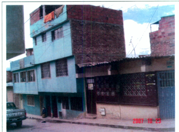
Fotografías No. 3. Tipología predominante de las viviendas en el desarrollo El Mirador I, que se caracteriza por viviendas en mampostería sin confinamiento estructural.
