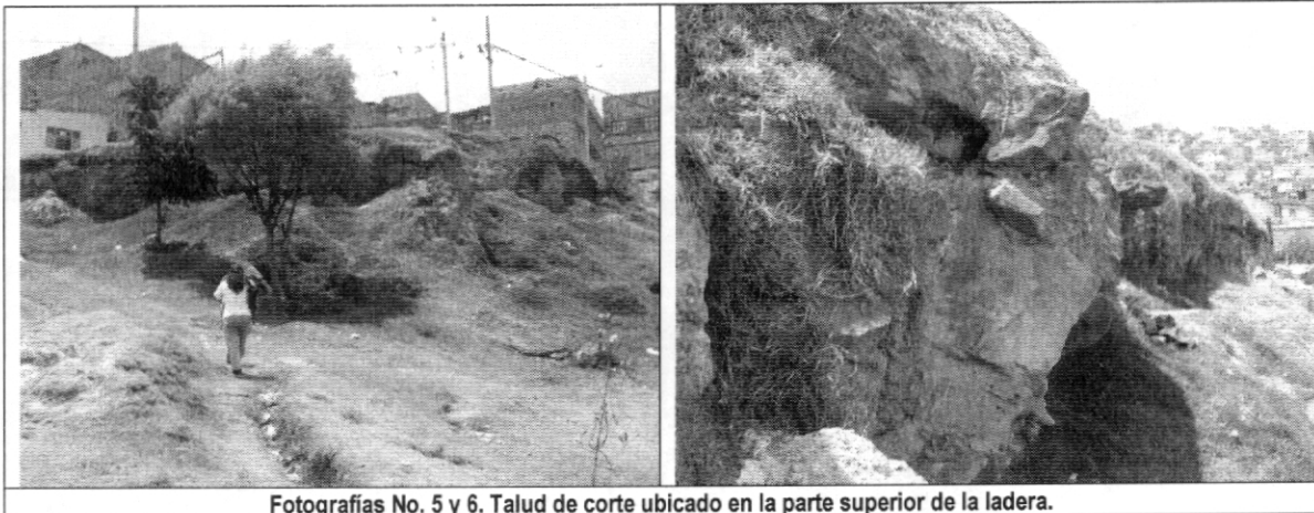
Fotografías No. 5 y 6. Talud de corte ubicado en la parte superior de la ladera.
