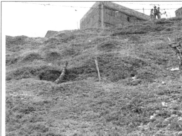
Fotografía No.7. Ondulaciones del terreno en el costado noroccidental de la zona verde.
