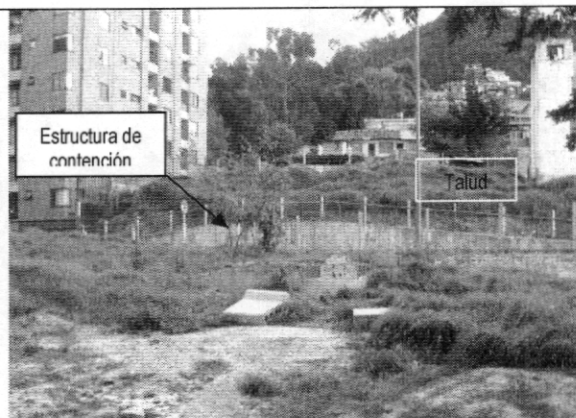
Fotografía No.4 Estructura de contención y talud que limitan el costado oriental de la carrera 3B.
