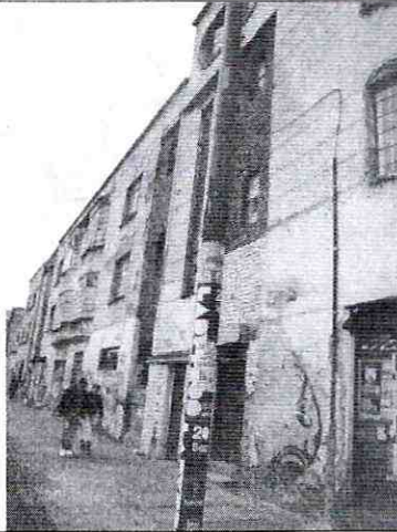
Fotografía No. 13: AK 14 entre CL 23 y CL 24 costado oriental. Edificación con lesiones mecánicas (desprendimientos).
