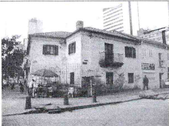
Fotografía No. 15: CL 24 por KR 13 costado nororiental. Edificación con lesiones mecánicas (desprendimientos).
