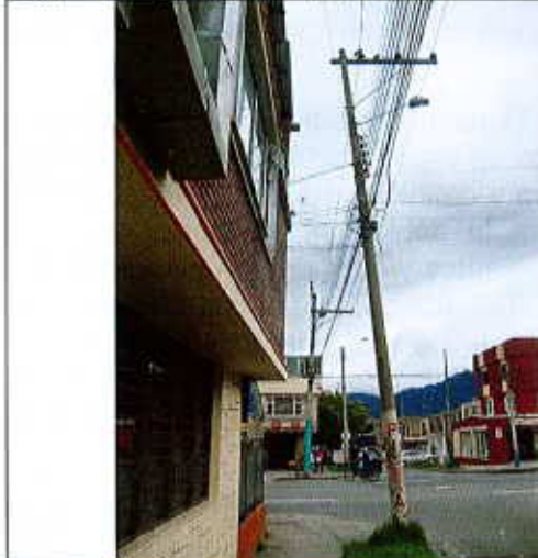
Fotografía No. 13: Manzana: 06. Frente: KR 9 (Sector Catastral Sociego). Se observa poste con pérdida de verticalidad y saturación del tendido aéreo.
