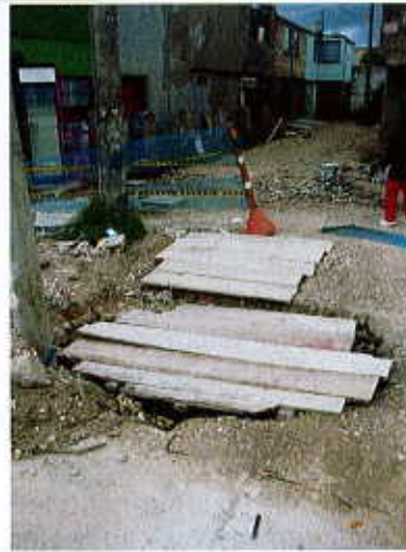
Fotografía No. 14: Manzana: 80. Frente: AK 10 (Sector Catastral Ciudad Jardín). Se observa inadecuado manejo de medidas de seguridad y de señalización en obras.
