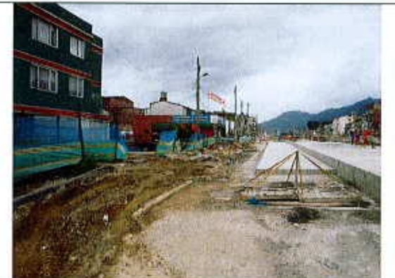
Fotografía No. 10: Frente: AK 10 Al Norte (Sector Catastral Ciudad Jardín). Se observa obra en infraestructura con deficiencias en cerramiento, señalización y en seguridad para peatones y trabajadores.
