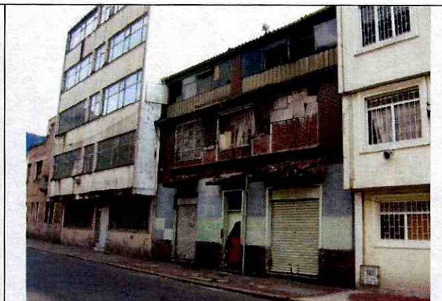
Fotografía No. 2: Se observa uso residencial y edificaciones que advierten abandono, deterioro físico avanzado en las edificaciones y leve en andén.
