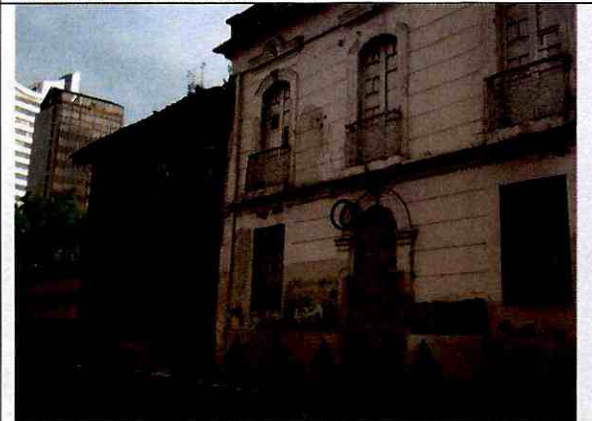
Fotografía No. 7: Se observan procesos patológicos en fachada en relación con pérdida de revestimientos y procesos lesivos en andén.
