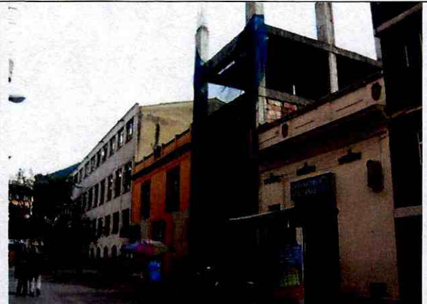
Fotografía No. 4: Se observa uso dotacional, de comercio vecinal y residencial, cambios físicos en fachadas, obra inconclusa en etapa de estructura y elementos de amoblamiento urbano.
