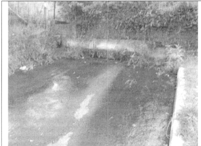
Fotografía No. 7. Manejo deficiente de agua de escorrentía en el sector.
