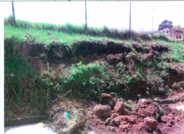
Fotografía No. 4. Desprendimiento de material en rellenos localizados en el costado occidental del plan parcial Mirador de Suba .
