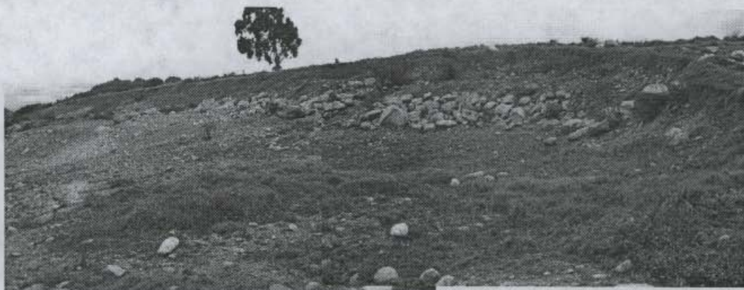
Fotografía N° 2. Se aprecia parte de las actividades que se han desarrollado para acondicionar uno de los patios donde se desarrolla beneficio de material pétreo.
