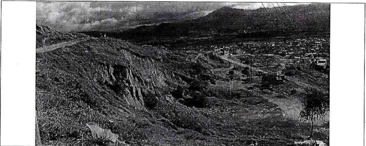
Fotografía 2. Vista hacia el sur, costado nororiental. Los escarpes de explotación son erosionados en su corona y avanzan en forma retrogresiva acercándose a uno de los carretables que comunican a través del predio los barrios aledaños (El Consuelo, Las Mercedes, El Socorro y La Esperanza).
