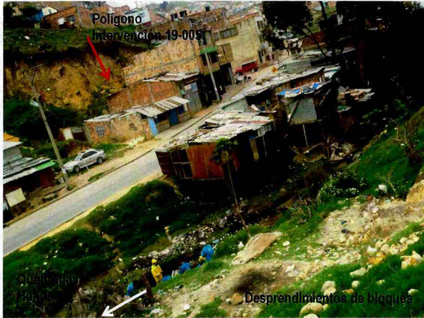
Foto 4. Desprendimiento de bloques de la Ladera de Acumulación y procesos de remoción en masa, polígono 19-005.
