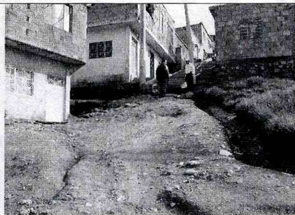
Fotografía No.5. Dig 61B Sur en la en la que se evidencia la falta de obras de drenaje superficial.
