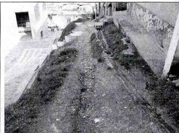
Fotografía No.4. Parte superior de la Dig 61B Bis en la que se evidencia la falta de obras de drenaje superficial.
