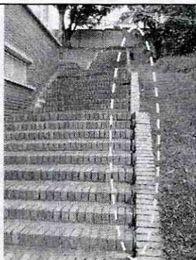
FOTO 6 Se observa separación en la estructura monolítica
