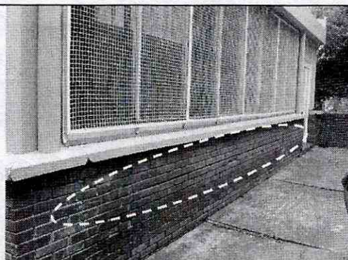
FOTO 7 Grietas a nivel de pega del muro de fachada del edificio donde funciona el COL
