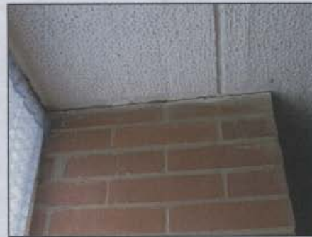
Fotografía 11 Dilatación entre un muro interior y la cubierta en la habitación del frente del segundo piso en la casa ubicada en la Calle 33 Bis Sur # 93 - 25
