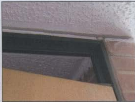
Fotografía 10 Desplazamiento de más de 1 cm del muro del closet en la habitación del frente del segundo piso en la casa ubicada en la Calle 34 Sur # 93 - 62
