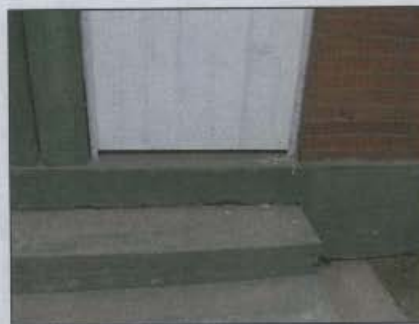
Fotografía 21 Dilatación frente a la casa ubicada en la Calle 33 Bis Sur # 93 - 73
