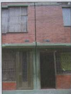
Fotografía 24 Abertura diferencial en la unión de dos unidades estructurales sobre la Calle 33 Bis Sur entre las casas número 93 - 25 y 93 - 27
