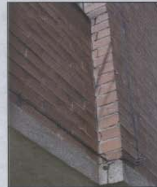
Fotografía 15 Grietas entre bloques en la fachada de la casa ubicada en la Calle 34 Sur # 93 - 38
