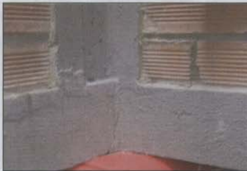
Fotografía 3 Grieta en la viga de amarre que se extiende entre las losas prefabricadas de la placa de entepiso en la casa ubicada en la Calle 33 Bis Sur # 93 - 01
