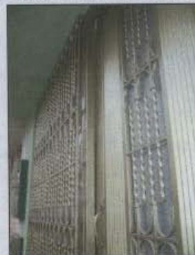
Fotografía 25 Deformación de la puerta de la casa ubicada en la Calle 33 Bis Sur # 93 - 25
