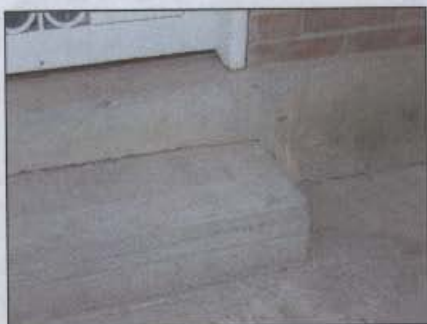
Fotografía 20 Dilatación frente a la casa ubicada en la Calle 33 Bis Sur # 93 - 01
