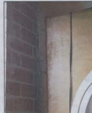
Fotografía 13 Abertura entre un muro interior y el muro de fachada en el segundo piso. Casa de la Calle 34 Sur # 93 - 38
