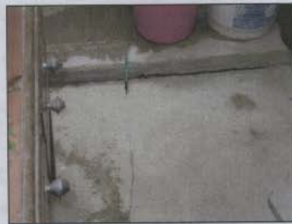
Fotografía 23 Hundimiento del piso del patio en la casa ubicada en la Calle 34 Sur # 93 - 62
