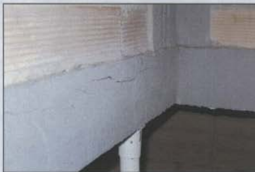
Fotografía 5 Grietas sub horizontales a lo largo de la viga ubicada en la zona de escaleras la casa ubicada en la Calle 33 Bis Sur # 93 - 19
