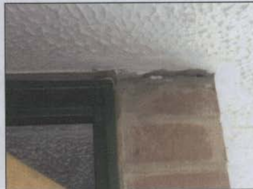
Fotografía 9 Desplazamiento de más de 1 cm del muro del closet en la habitación del frente del segundo piso en la casa ubicada en la Calle 34 Sur # 93 - 50
