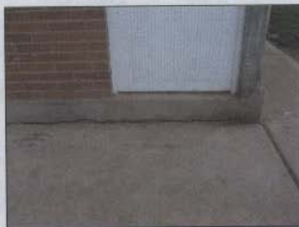
Fotografía 22 Dilatación frente a la casa ubicada en la Calle 33 Bis Sur # 93 - 81
