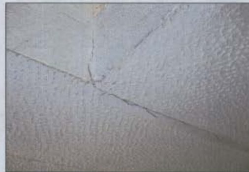
Fotografía 4 Grieta en la viga de amarre que se extiende entre las losas prefabricadas de la placa de entepiso en la casa ubicada en la Calle 33 Bis Sur # 93 - 31
