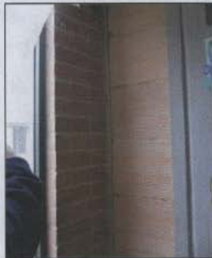
Fotografía 12 Abertura entre un muro interior y el muro fachada en la casa ubicada en la Calle 34 Sur # 93 - 62
