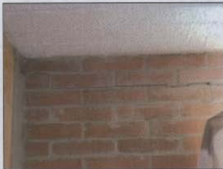
Fotografía 16 Grieta horizontal en el muro fachada del segundo piso de la casa de la Calle 33 Bis Sur # 93 - 01
