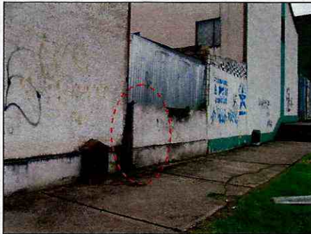
Fotografía 10 Muro colapsado y con signos de un desplazamiento en la Carrera 5 con calle 33C sur (Mz 94)
