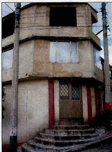
Fotografía 32 Ampliación a 3 pisos de una casa originalmente de 2 en la Calle 36B sur con Carrera 2
