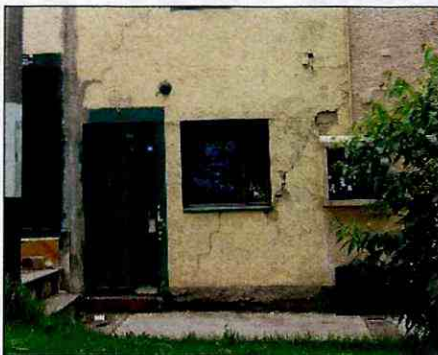
Fotografía 26 Agrietamiento severo de algunas viviendas de la manzana 83, sobre la Tv. 4Bis
