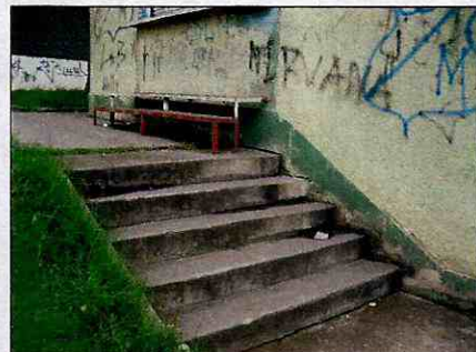
Fotografía 9 Dilatación y humedad en la zona de escaleras en la Carrera 4 entre calles 33C y 34 sur
