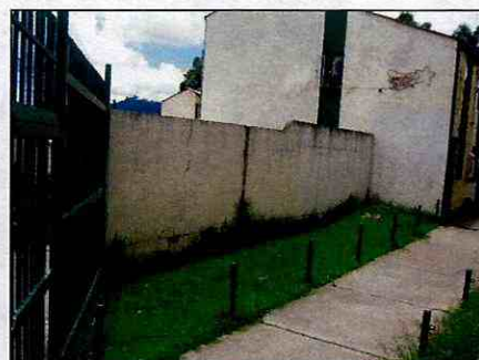
Fotografía 19 Agrietamiento del muro de la Diagonal 33 sur con Carrera 5 (Mz 82)
