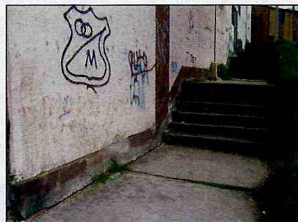
Fotografía 8 Dilatación en la zona de escaleras en la Carrera 2B con Diagonal 32B sur
