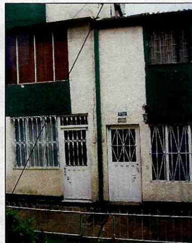
Fotografía 31 Grieta vertical en la unión de las dos unidades estructurales, posiblemente debido a la ampliación hecha en la casa de la izquierda (Carrera 4B con Calle 36 Sur)
