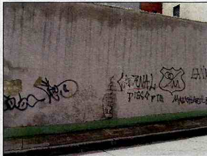
Fotografía 14 Agrietamiento del muro en la Transversal 4C con Calle 35A sur (Mz 11)
