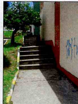
Fotografía 2 Hundimiento del andén sobre la Carrera 3A entre calles 36B y 36C sur, al oeste del parqueadero
