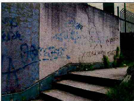
Fotografía 18 Agrietamiento del muro de la Carrera 5 con Diagonal 33 sur (Mz 82)
