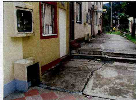
Fotografía 7 Dilatación y hundimiento en la Calle 34A sur con Carrera 4A
