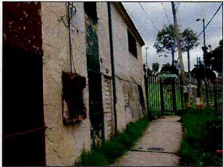
Fotografía 22 Detalle de la deformación de la manzana 75 al final de la Calle 36 Sur
