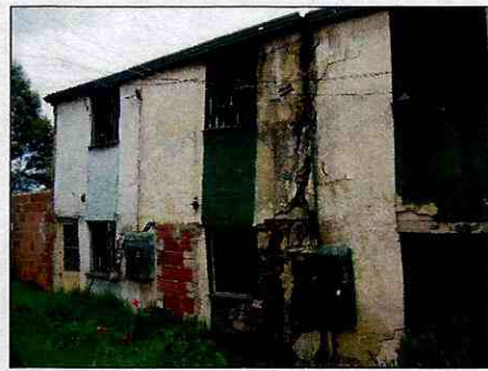
Fotografía 23 Detalle de los daños en las casas de la manzana 74, al final de la Calle 36G Sur
