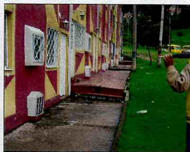
Fotografía 4 Hundimientos del andén e inclinación de postes sobre la Transversal 4C al sur de la Calle 36B
