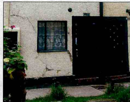
Fotografía 27 Agrietamiento severo de algunas viviendas de la manzana 83, sobre la Tv. 4Bis
