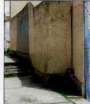
Fotografía 13 Inclinación del muro de cerramiento en la Calle 34A sur con Carrera 4A sur (Mz 9)
