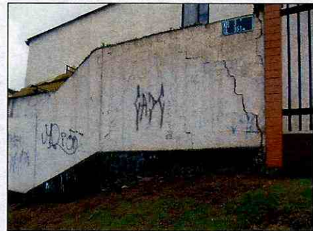
Fotografía 11 Agrietamiento severo en el muro de un patio en la Carrera 3B con Calle 35B sur (Mz 46)
