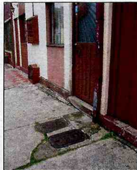
Fotografía 6 Dilatación puntual en la Calle 35A sur con Carrera 1A
