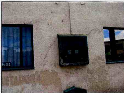
Fotografía 28 Grietas en la fachada de la casa ubicada en la Calle 34A # 3A - 21
