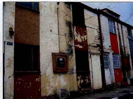
Fotografía 25 Detalle de los daños de las viviendas de la manzana 74 al final de la Calle 36F Sur
