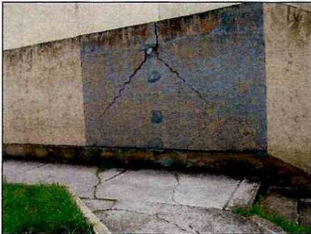
Fotografía 12 Agrietamiento severo del muro en la Calle 34A sur con Carrera 4A sur (Mz 9)
