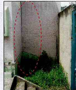
Fotografía 15 Agrietamiento e inclinación del muro en la Calle 35A sur con Transversal 4C (Mz 11)
