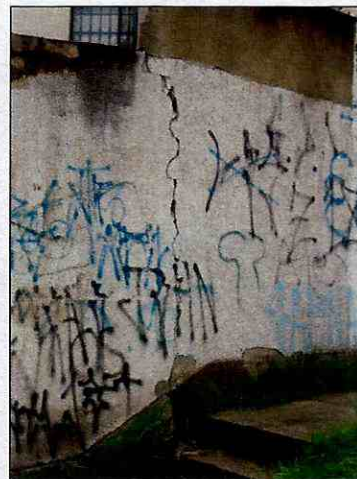
Fotografía 17 Detalle del agrietamiento en el muro de cerramiento entre la Transversal 4C y la Calle 36B Bis Sur (Mz 24)
