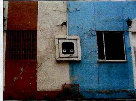
Fotografía 21 Patrón de agrietamiento en las casas de la manzana 75 en la Calle 36G Sur
