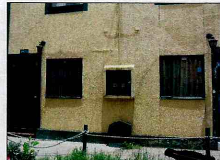
Fotografía 29 Grietas recientemente reparadas en la fachada de algunas casas sobre ubicadas sobre la Diagonal 33 sur entre carreras 4A Bis y 5
