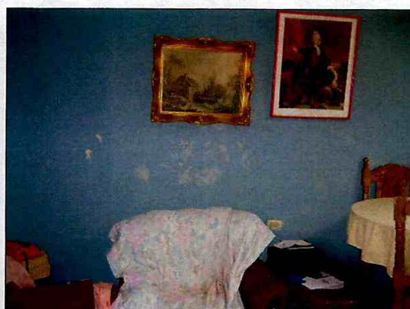
Fotografía 8 Presencia de humedad en la vivienda
