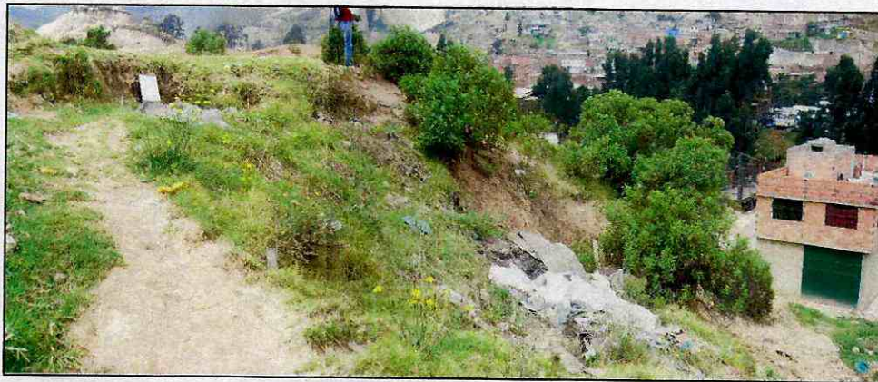
Fotografía 2 Vivienda en riesgo por deslizamiento ubicada en la Calle 80A Bis Sur con Cra 16 Bis B
