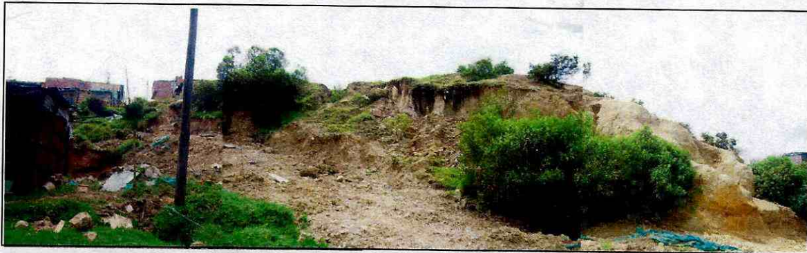
Fotografía 4 Vivienda en riesgo por deslizamiento ubicada en la Calle 80A Bis Sur con Cra 16 Bis B
