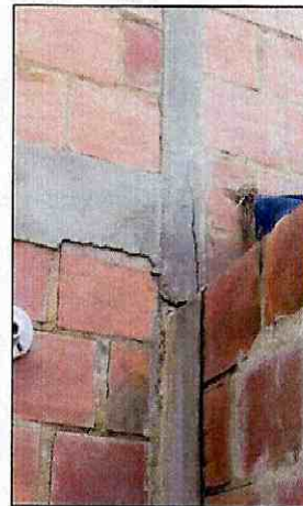
Fotografía 21 Desplazamiento del muro del patio y grieta en la columna de la Cra. 72 # 68A-26 Sur
