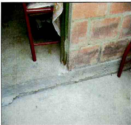
Fotografía 34 Hundimiento del patio de la casa ubicada en la Cra. 71J # 68A-15 Sur
