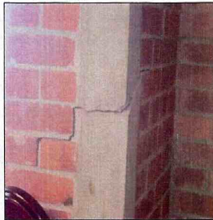
Fotografía 29 Desplazamiento en el muro de la habitación principal en la Cra. 71J # 68A-11 Sur
