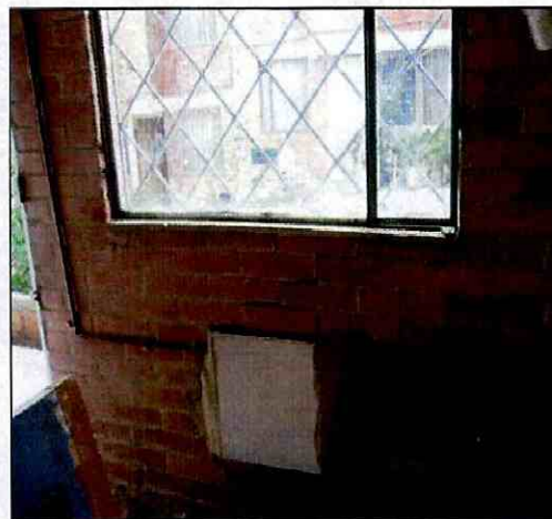
Fotografía 35 Grietas escalonadas en la fachada de la casa ubicada en la Cra. 71J # 68A-17 Sur
