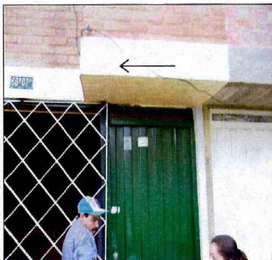
Fotografía 8 Inclinación de la puerta y el marco de la ventana de casa ubicada en la Cra. 72 # 68A-02
