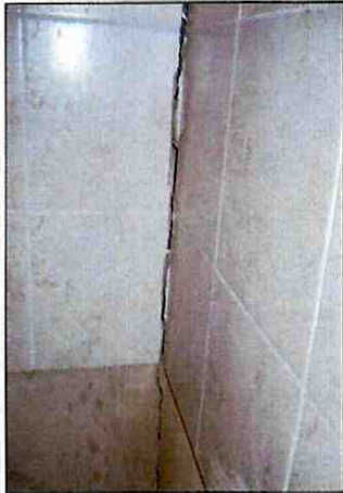
Fotografía 12 Abertura en las paredes del baño de la casa de la Cra. 72 # 68A-08 Sur
