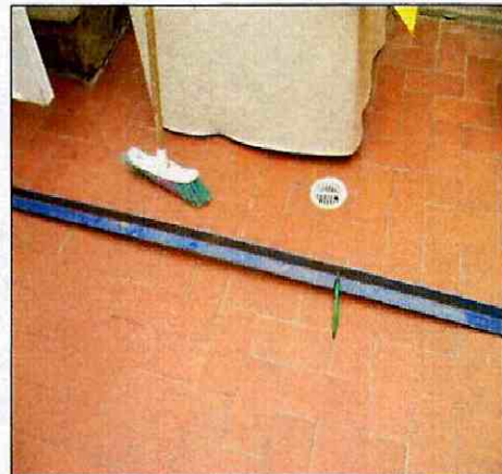
Fotografía 15 Hundimiento del piso en el patio de la casa de la Cra. 72 # 68A-20 Sur
