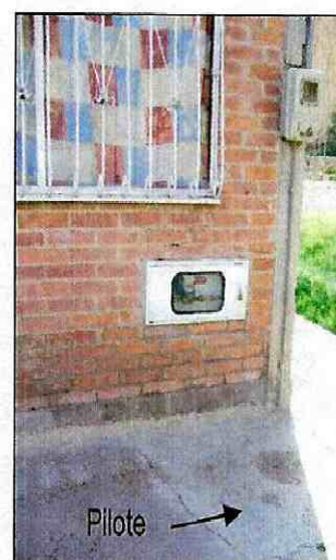
Fotografía 2 Grietas entre los ladrillos de la fachada de la casa de la Cra. 72 # 68A-34 Sur que se produjeron después de la instalación de los pilotes
