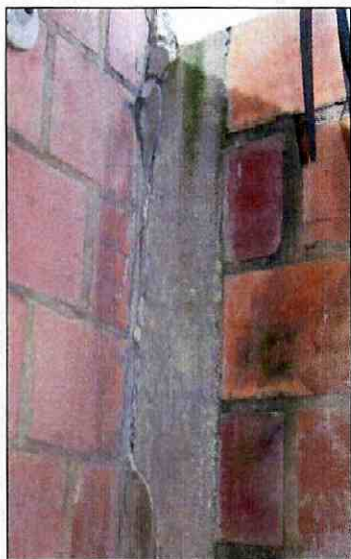
Fotografía 10 Desplazamiento en los muros del patio en la casa de la Cra. 72 # 68A-08 Sur
