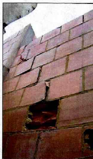
Fotografía 39 Grieta en el patio de la casa ubicada en la Cra. 71J # 68A-23 Sur
