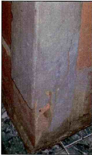
Fotografía 18 Grieta en una supuesta columna de la casa de la Cra. 72 # 68A-20 Sur
