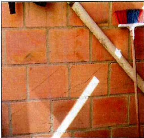
Fotografía 26 Grietas diagonales en el muro del patio de la casa ubicada en la Cra. 72 # 68A-34 Sur
