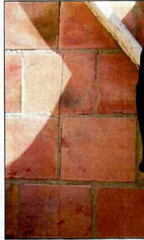
Fotografía 25 Grietas verticales en el muro del patio de la casa ubicada en la Cra. 72 # 68A-34 Sur
