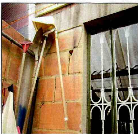
Fotografía 16 Aberturas escalonadas en el muro de la cocina de la casa de la Cra. 72 # 68A-20 Sur
