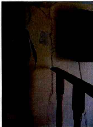
Fotografía 28 Grieta en la sala de la casa ubicada en la Cra. 71J # 68A-10 Sur
