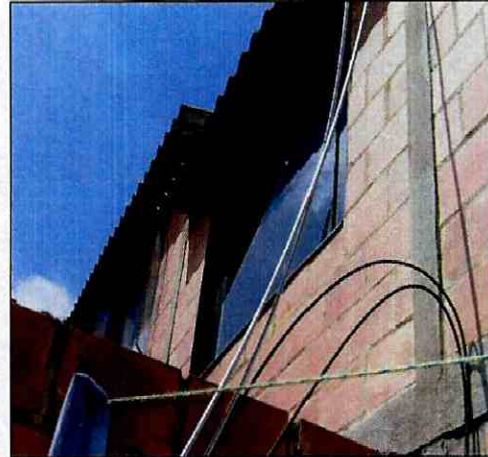
Fotografía 13 Rotura de una de las ventanas de la casa de la Cra. 72 # 68A-10 Sur
