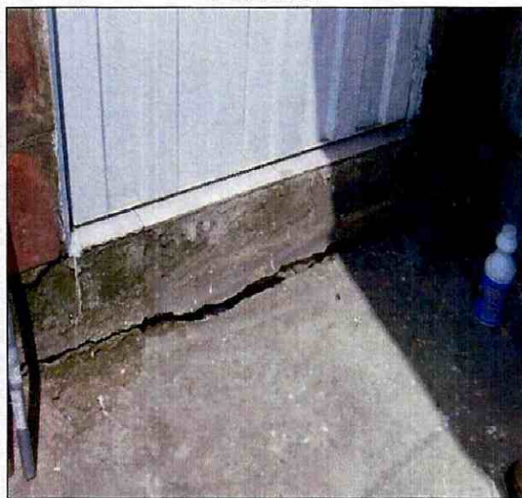
Fotografía 11 Hundimiento en el piso del patio de casa de la Cra. 72 # 68A-08 Sur
