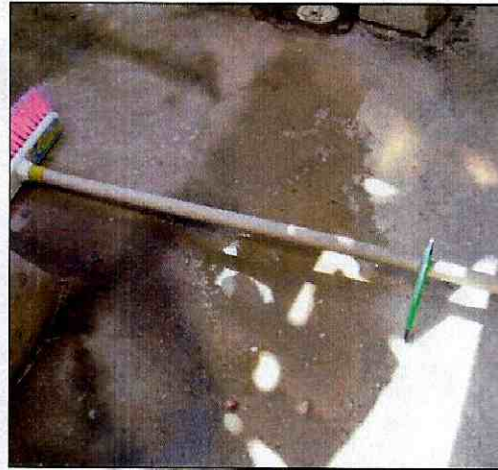
Fotografía 19 Hundimiento del piso del patio en la casa de la Cra. 72 # 68A-22 Sur
