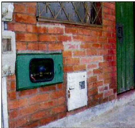
Fotografía 14 Grietas escalonadas en el muro de fachada de la Cra. 72 # 68A-14 Sur
