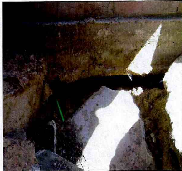
Fotografía 4 Detalle del hundimiento en el patio de la casa ubicada en la Cra. 72 # 68A-22 Sur
