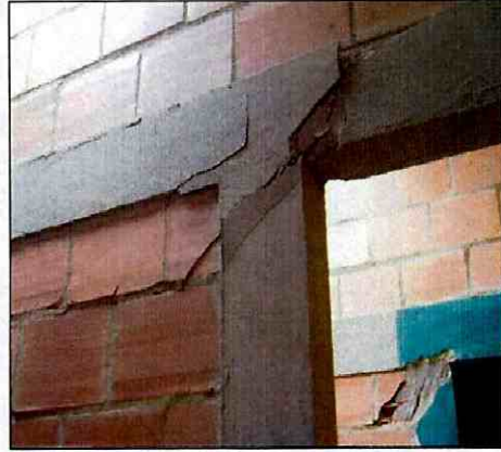
Fotografía 31 Grieta en las vigas y columnas de la casa ubicada en la Cra. 71J # 68A-15 Sur
