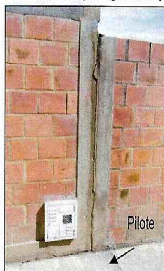
Fotografía 1 Separación entre los muros de la cocina y el patio después de la instalación del pilote junto a la casa de la Cra. 72 # 68A-34 Sur
