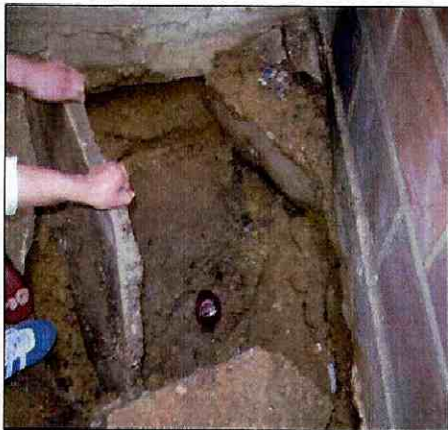
Fotografía 20 Hundimiento del pilote recién instalado en el patio de la Cra. 72 # 68A-22 Sur
