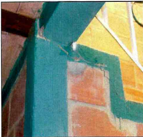
Fotografía 32 Grieta en la sala de la casa ubicada en la Cra. 71J # 68A-10 Sur
