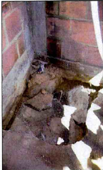
Fotografía 3 Hundimiento del pilote recién instalado en la Cra. 72 # 68A-22 Sur
