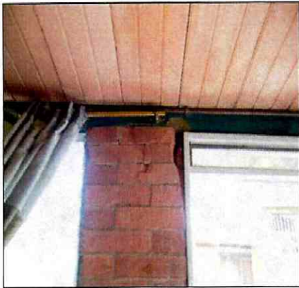
Fotografía 30 Dislocación el muro de la cocina de la casa ubicada en la Cra. 71J # 68A-15 Sur
