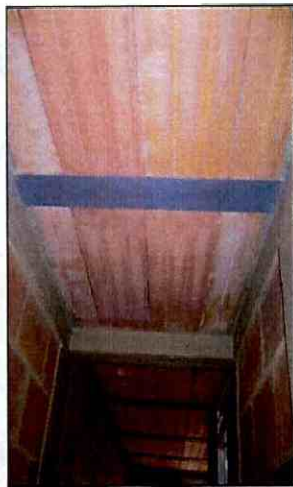
Fotografía 24 Deformaciones en las placas de entrepiso de la casa de la Cra. 72 # 68A-34 Sur
