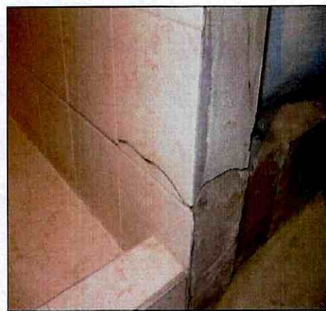
Fotografía 33 Grieta en la sala de la casa ubicada en la Cra. 71J # 68A-10 Sur
