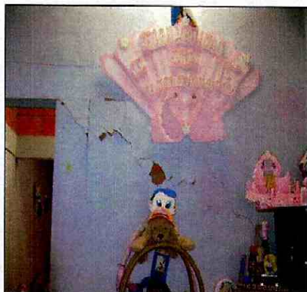
Fotografía 40 Grieta en una habitación de la casa ubicada en la Cra. 71J # 68A-23 Sur
