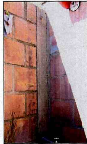
Fotografía 27 Abertura en la junta de los muros del patio de la casa ubicada en la Cra. 72 # 68A-34
