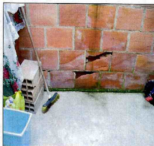
Fotografía 23 Gritas en los bloques del muro del patio de la Cra. 72 # 68A-28 Sur
