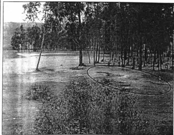
Foto No. 6. Se observa un sector de la parte norte del predio afectada por tubificación y colapso posterior del socavón.
