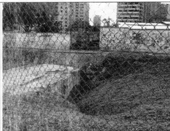
Fotografía 3. Antiguo puente sobre el río San Francisco el cual se encuentra cercado para su protección.
