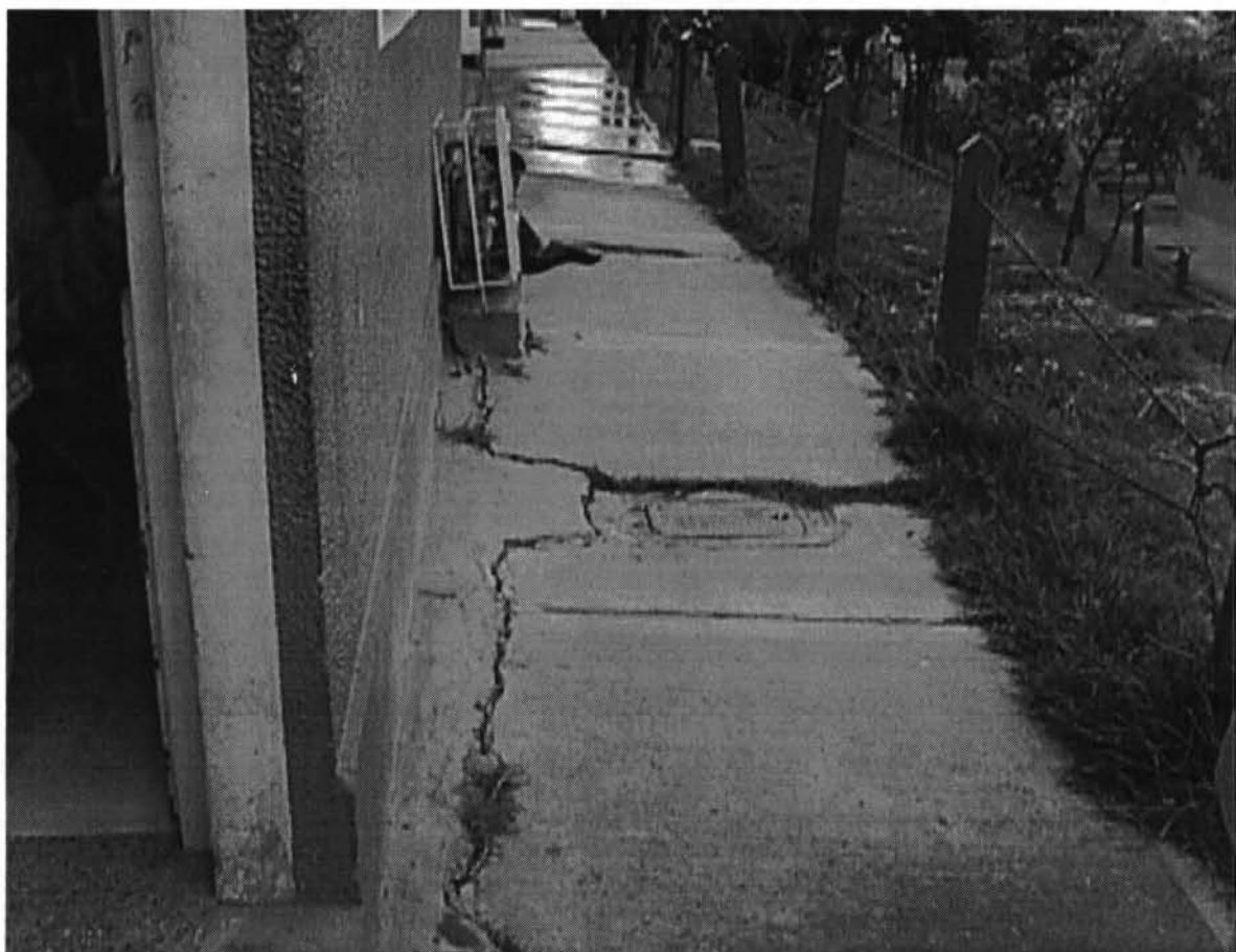
Fotografía No. 6. Agrietamiento de la losa del andén y subsidencia del terreno, lo cual indica movimiento del mismo en dirección del talud de corte en el límite con el área destinada para la segunda etapa.
