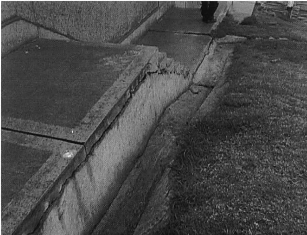
Fotografía No. 5. Separación de las losas del andén con respecto a la cuneta, lo cual facilita la infiltración de las aguas lluvias, generando un lavado del material de base.
