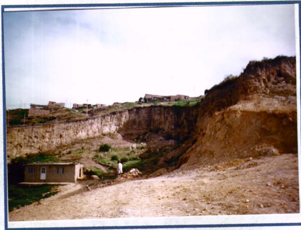
Foto 5 sector D talud muy fracturado de areniscas con una altura de aproximadamente 15 metros.
