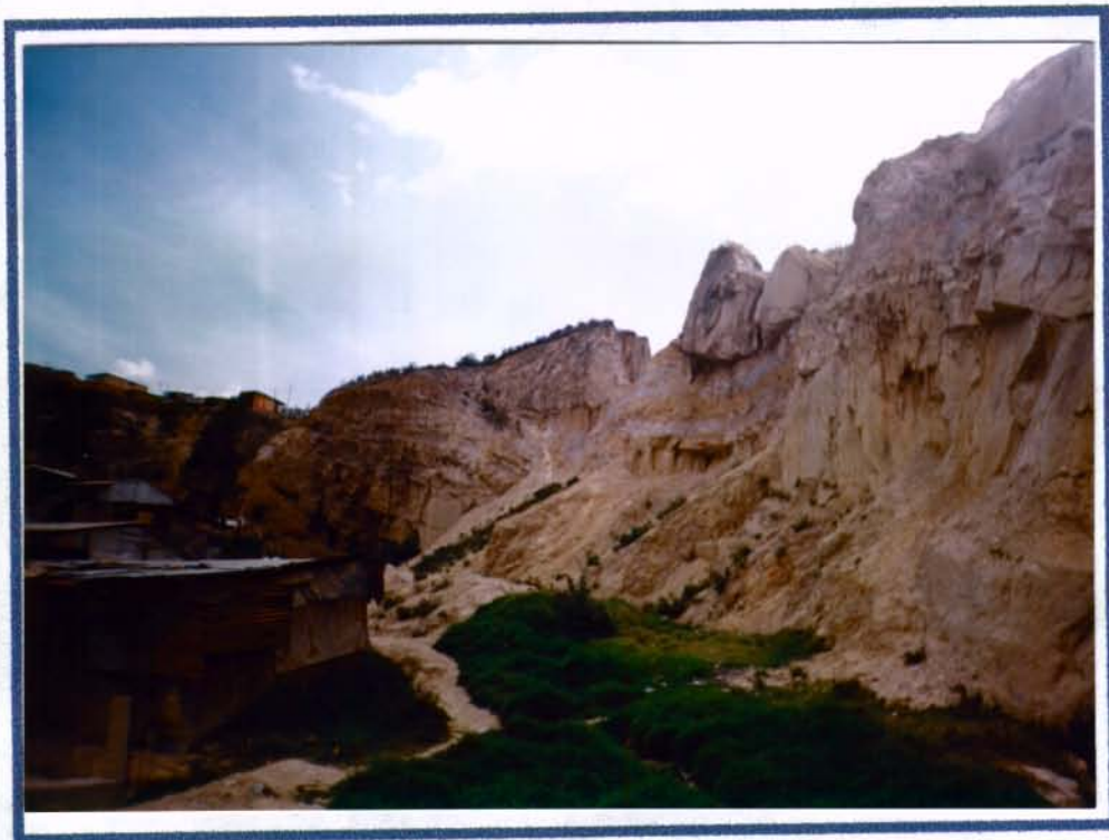
Foto 6 Sector A, en el primer plano se aprecian las casas tuguiriales expuestas a la amenaza por caída de bloques que se observan en la parte superior del talud.
