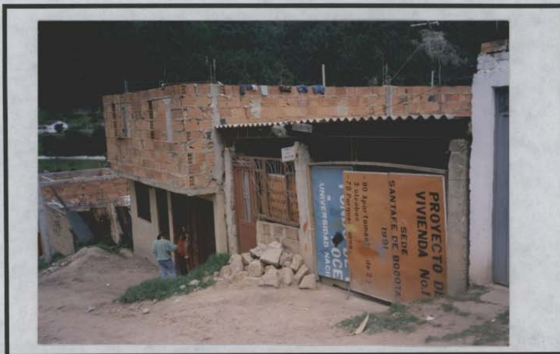
R-8713 F-8 SE OBSERVA SEPARACION DE MUROS Y COLUMNAS ENTRE VIVIENDAS UBICADAS SOBRE ZONA INESTABLE ACTIVA (CRA. 17 A ESTE)
