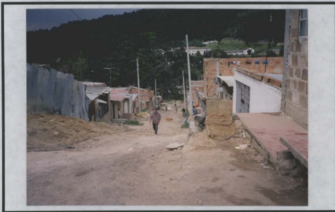
R-8713 F-10 PANORAMICA VIVIENDAS LOCALIZADAS SOBRE LA CRA. 17 A ESTE UBICADAS EN ZONA INESTABLE ACTIVA.
