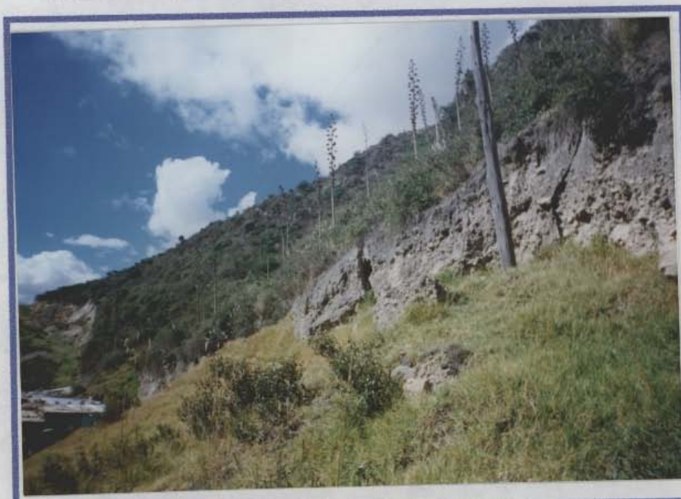
Foto 6 Bloques críticos y amenazantes sobre las casas construidas mas abajo del talud 6, detrás del cual esta la cantera.
