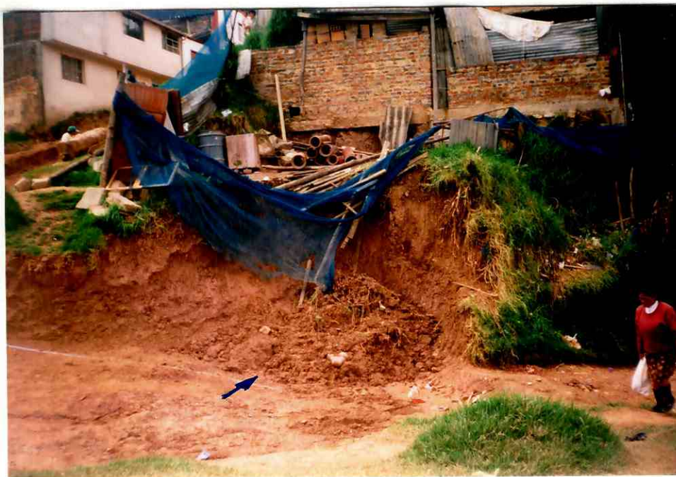
Fotografía No. 2. Detalle del deslizamiento del material que sirve de soporte a la vivienda en peligro de moverse.
