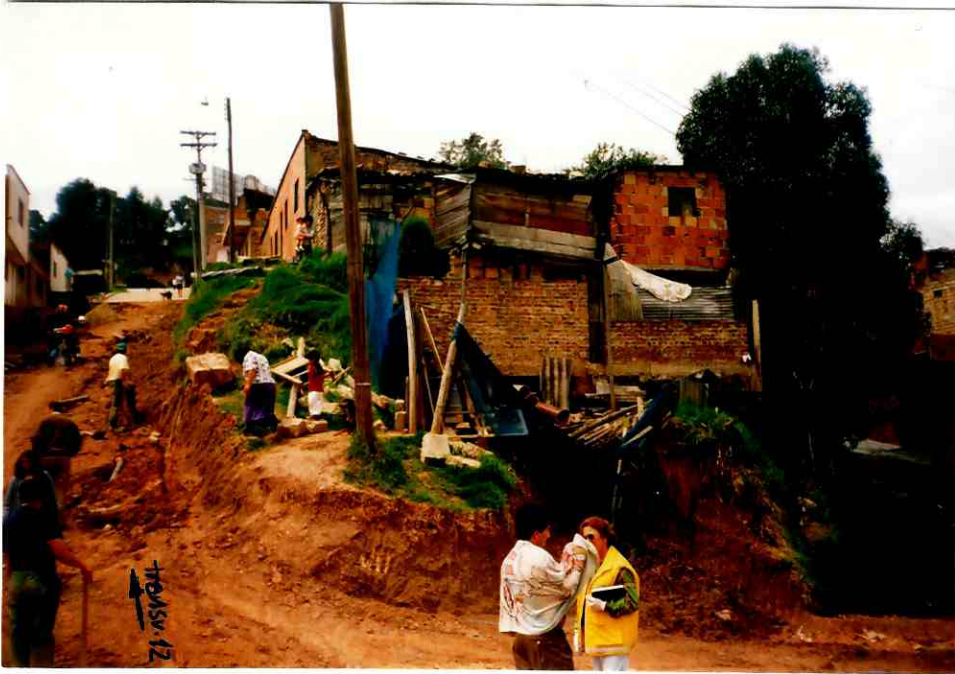
Fotografía No. 1. Las casas ubicadas en la ladera están dentro del programa de reubicación, en vista de que se encuentran en alto riesgo generado por el movimiento del terreno.
