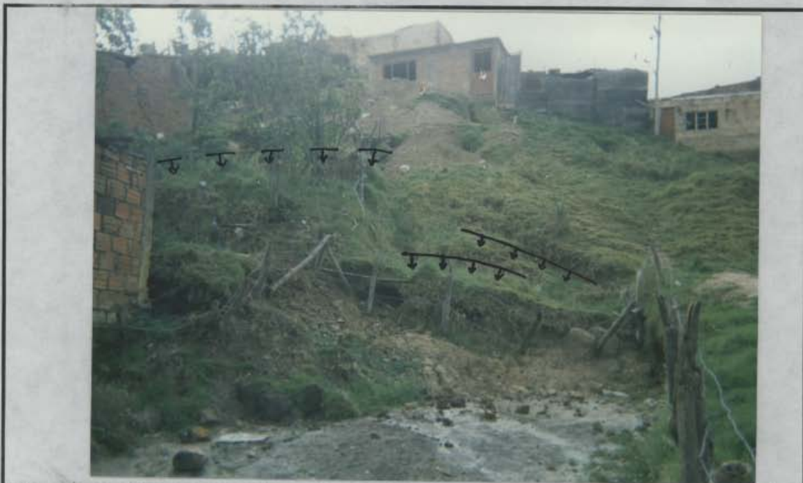
FOTO No. 1 DIAGT. No. 306 DESCRIPCIÓN: Obsérvese las coronas de deslizamiento y el "moteado" característico del fenómeno de reptación. En la parte inferior se alcanza a notar las costras de una filtración. LOCALIZACIÓN: Cra 8 Este Con Cille 80A Sur, barrio Yomasita, Loc. Usme
