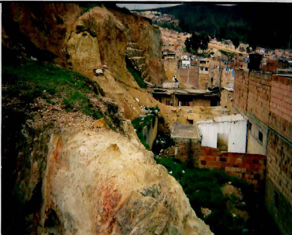
FOTO No. 2 CONCEPTO No.2707 DESCRIPCIÓN: Obsérvese la altura y pendiente del talud afectado, la ubicación del muro en gaviones y, en la mitad derecha de la foto, las dos viviendas que resultaron seriamente afectadas por el movimiento de masa. LOCALIZACIÓN: Cra 5L con Cllé 48Q Sur, Barrio Mirador de Marruecos, Loc. 18
