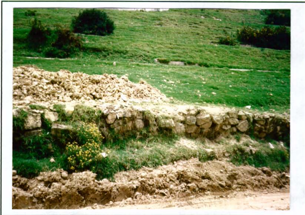
Obsérvese muro en gaviones desplazado en su parte superior.
