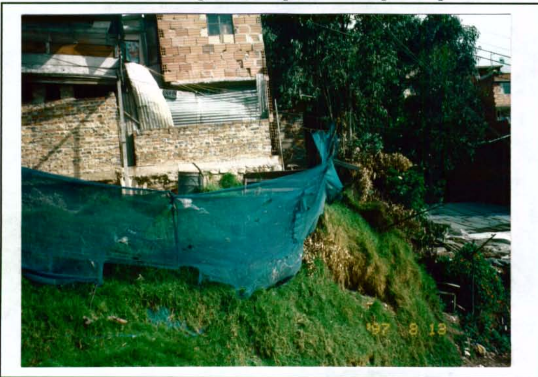
Viviendas con problemas en el suelo de cimentación. (23, 24 y 25)
