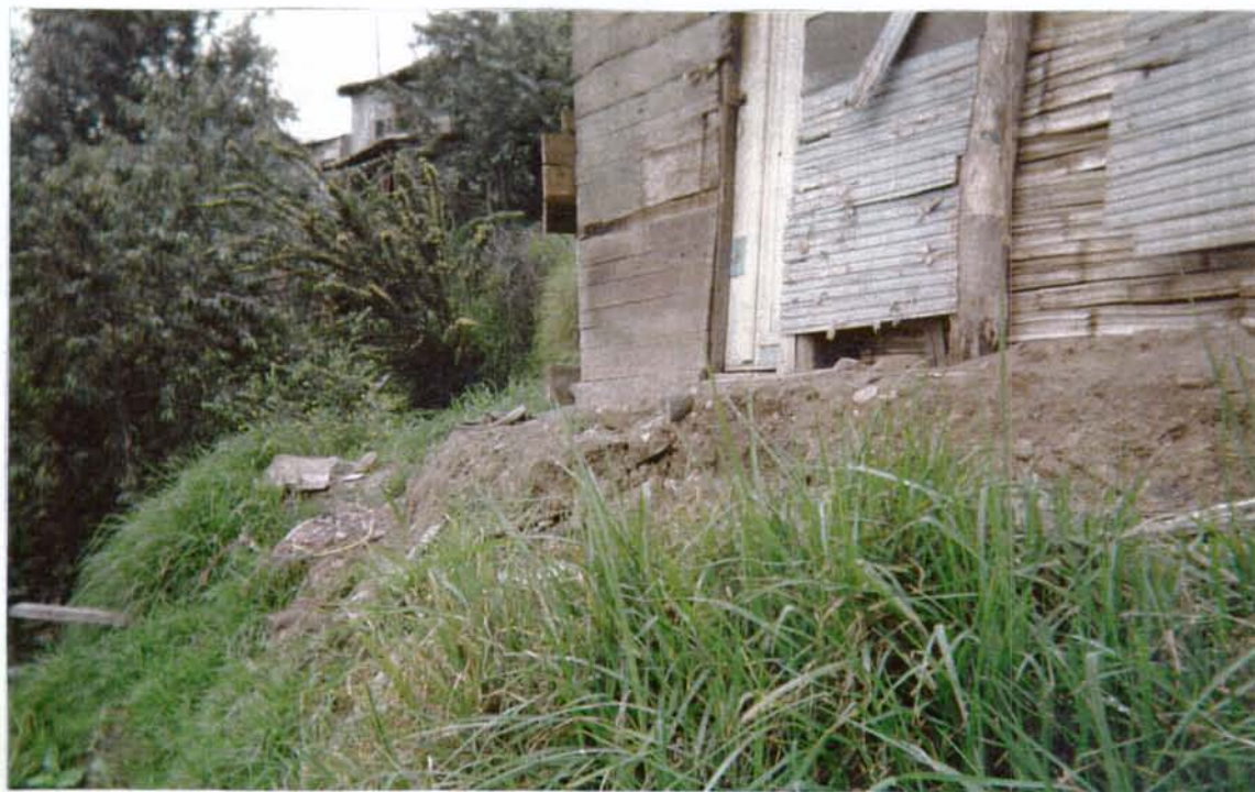
Foto No. 2. Desplazamiento de mas de 10 cm. en el terreno, frente a la casa con dirección Clle 2D # 6-42 Este.
