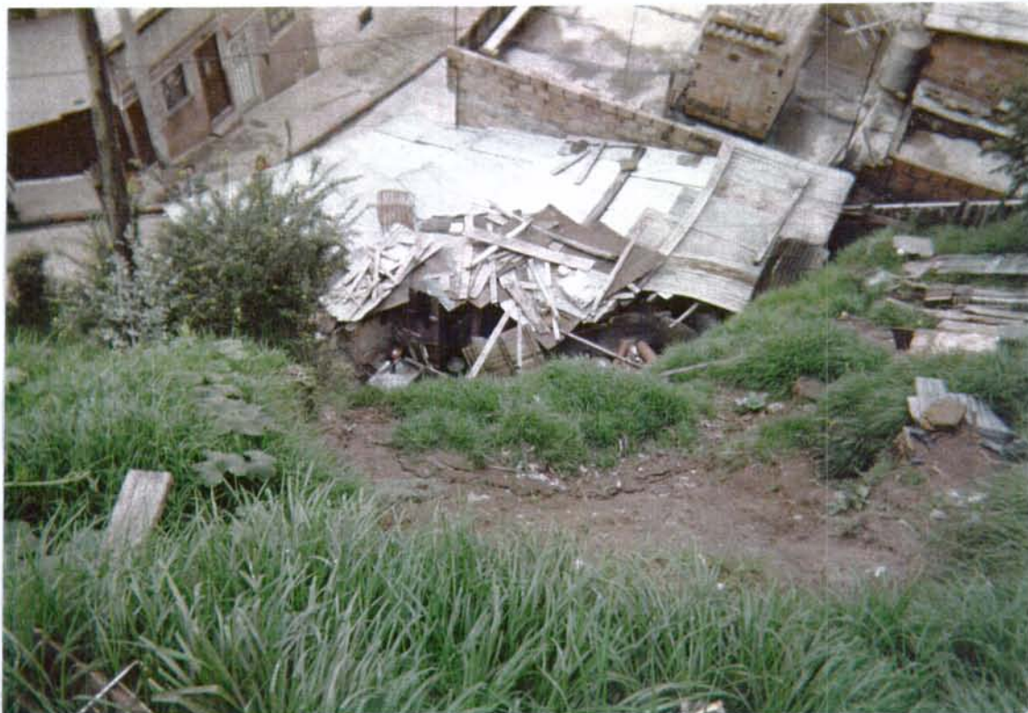
Foto No. 1. Obsérvese grieta en el material que ya ha sido desplazado. Parte posterior de la casa con dirección Clle 2 D # 6-18 Este.
