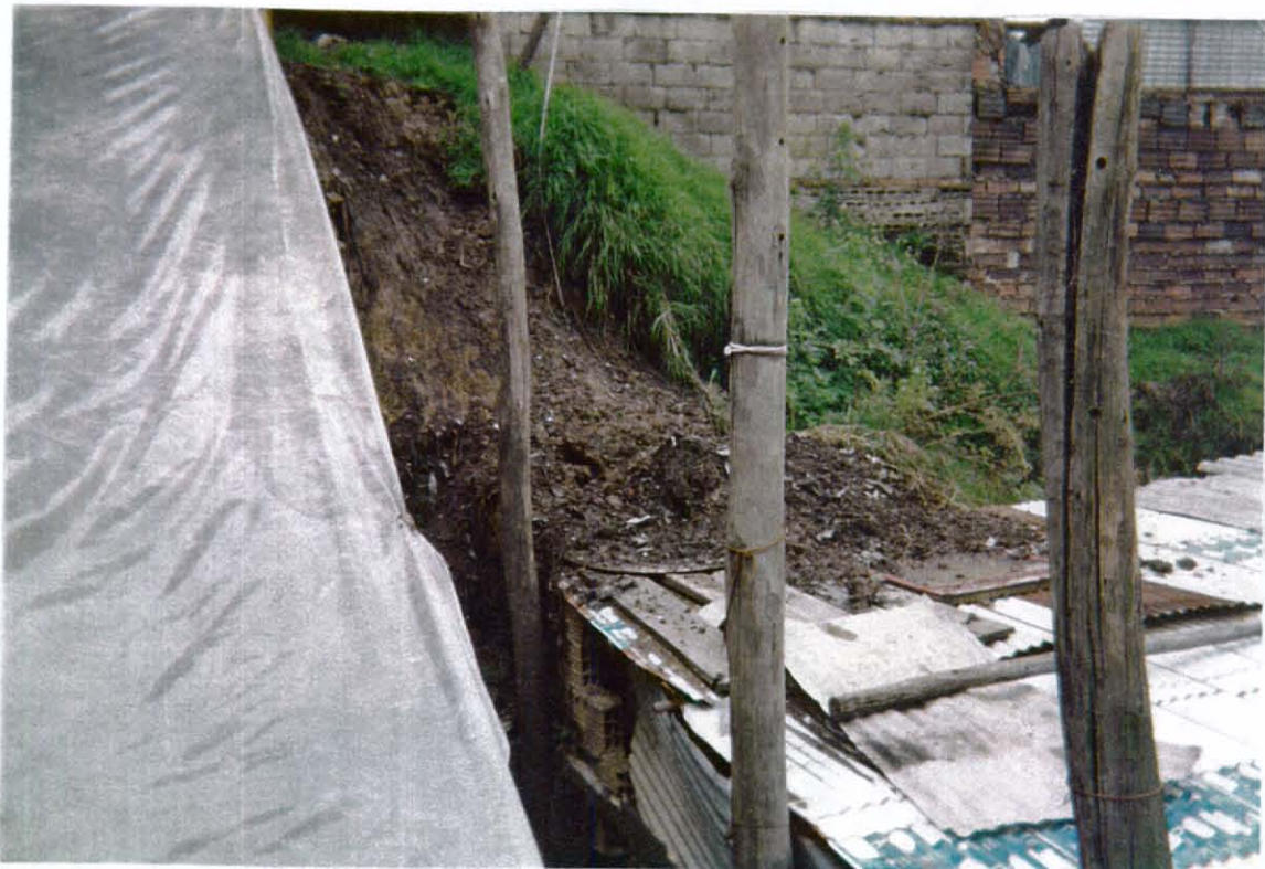
Foto No. 2. Deslizamiento en la parte posterior de la casa con dirección Diag. 5 Bis # 9C-87 Este.
