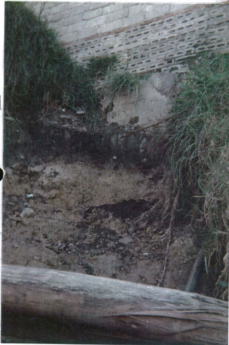
Foto No. 4. Pared que amenaza con desplomarse sobre la casa con dirección Diag. 5 Bis # 9C-81 Este.
