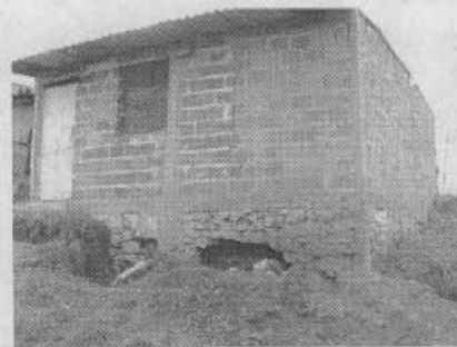
Fotografía 4 Mz 19 Lt 12. El agrietamiento del terreno afectó la cimentación de la construcción y ocasiona la rotura de las redes domiciliarias.
