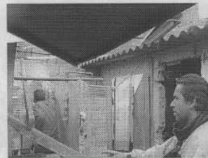
Fotografía 4 Mz 7 Lt 19. Se observa el desplome del techo por el desplazamiento de los muros que dejaron sin soporte la estructura de cubierta en la parte media del predio.
