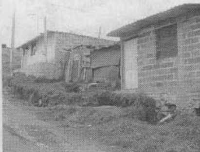
Fotografía 3 Extremo oriental manzana 19. Se observa grieta principal frente a los predios, dificultando acceso.
